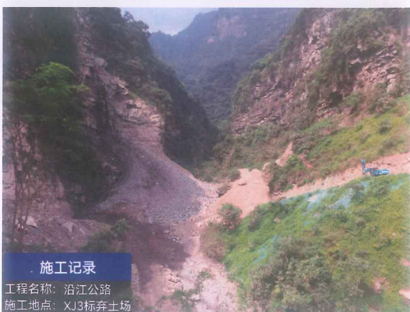
3 标段 K11+900 弃渣场未修建泄洪渠及拦挡
