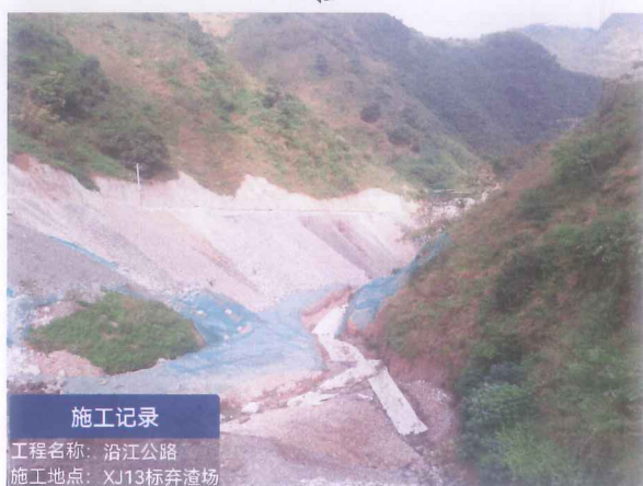
13 标段 K72+100 鲁村沟弃渣场堆渣前未剥离表土
