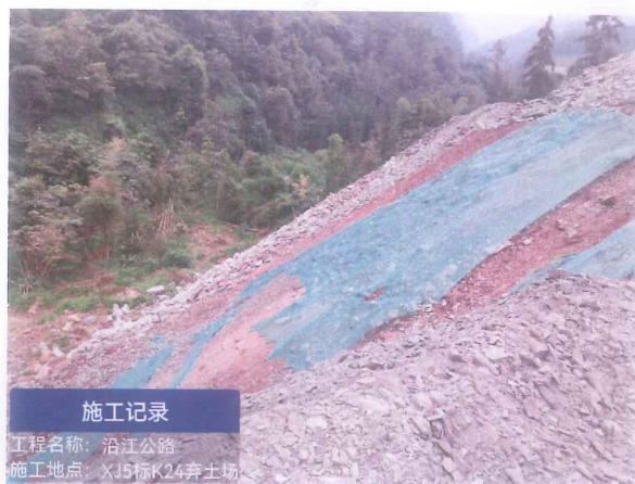
5 标段 K24+000 弃渣场堆渣坡度过大
