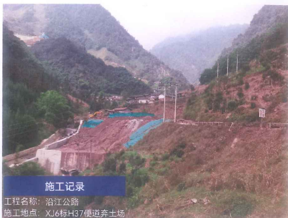
H37 便道 2#弃渣场弃渣外溢
