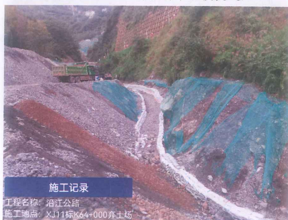
11 标段 K64+000 弃渣场堆渣坡度过大
