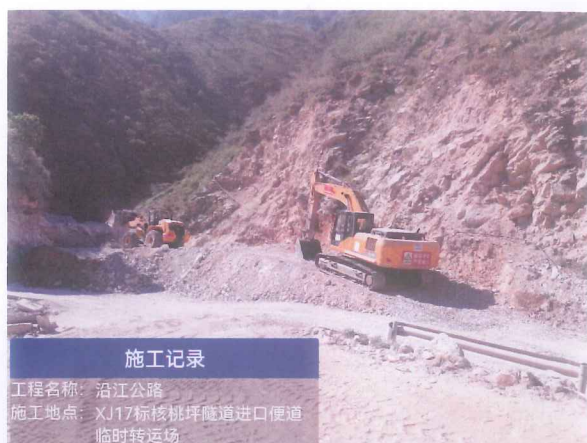
17 标段核桃坪隧道进口临时转运场未修建临时拦挡
