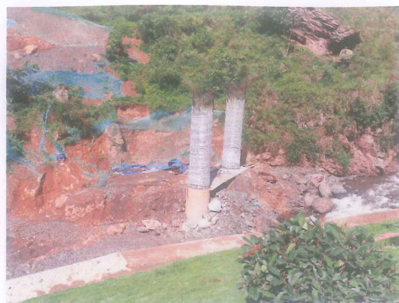
9 标段锦屏隧道出口临河桥墩未修建临时围堰
