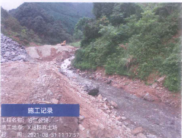
8 标段 K39+800 弃渣场未修建拦挡
