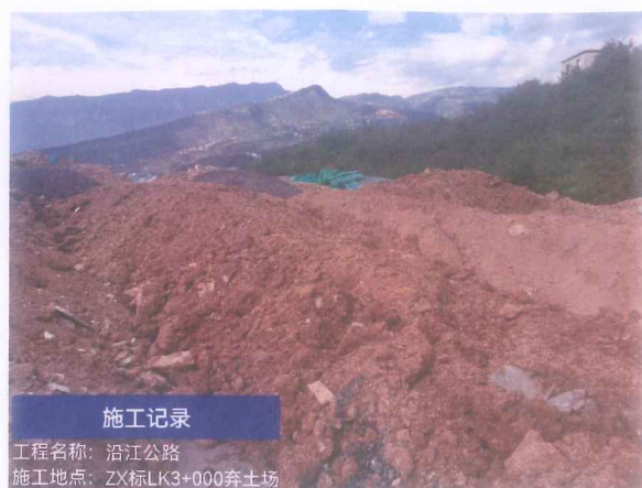
LK3+000 表土堆放场表土未集中堆放
