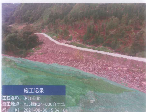
5 标段 K24+000 英雄村沟弃渣场堆渣前未剥离表土
