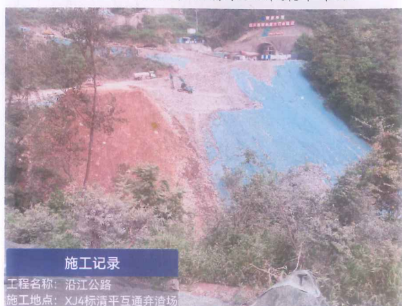
4 标段 K17+800 弃渣场未修建泄洪渠及堆渣坡度过大
