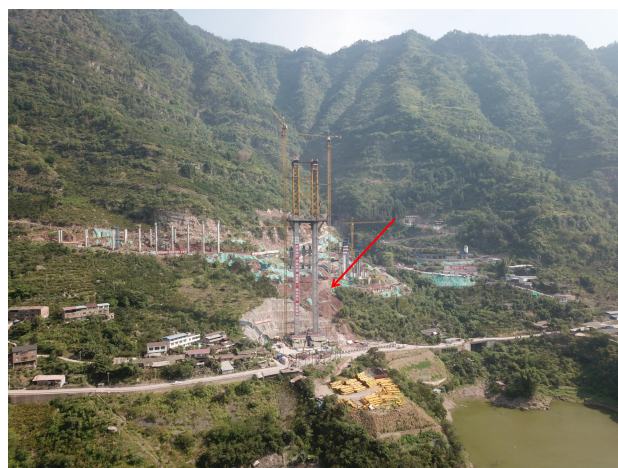
新市互通边坡挂渣
