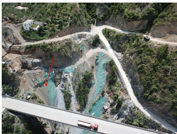
丰家坪大桥边坡挂渣
