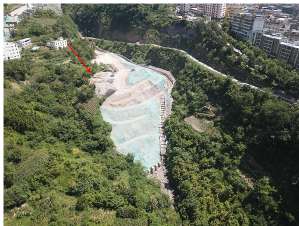
弃渣场里侧未设置排水措施
