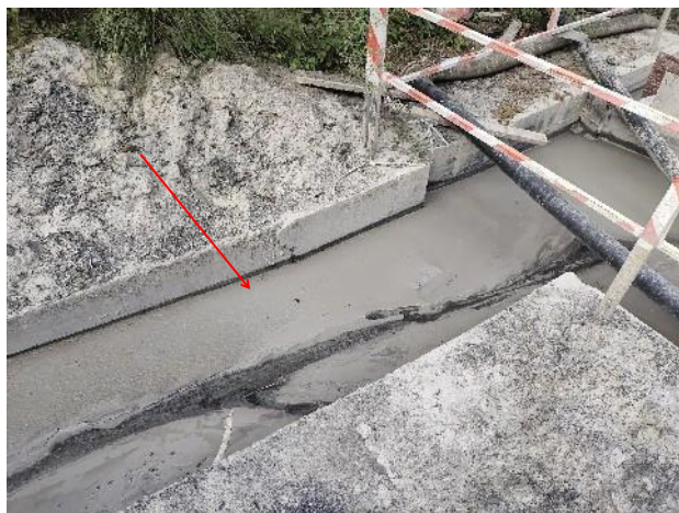
马鞍山隧道斜井口排水沟堵塞
