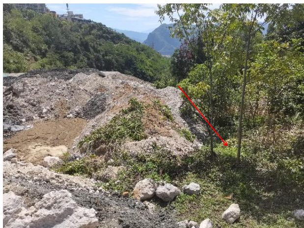
弃渣场里侧未设置排水措施
