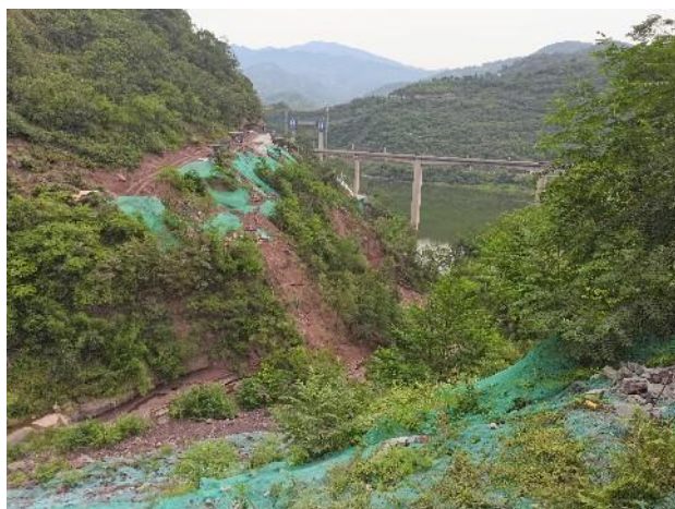
中都河特大桥施工便道边坡挂渣
