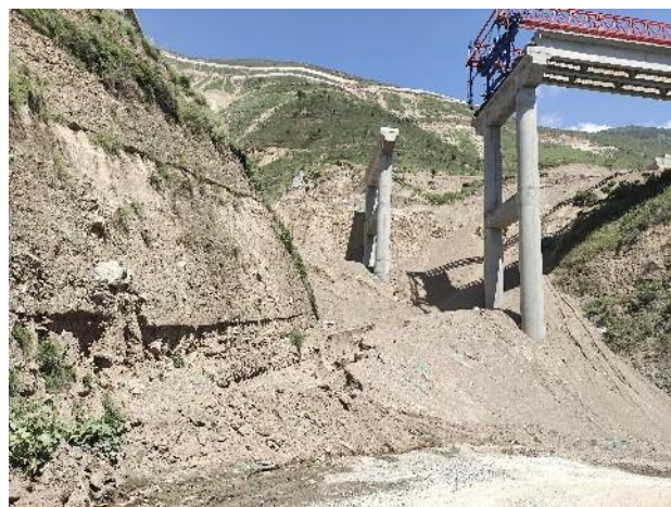
德溪互通施工便道边坡挂渣
