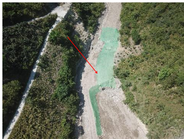
弃渣场渣体漫出挡墙
