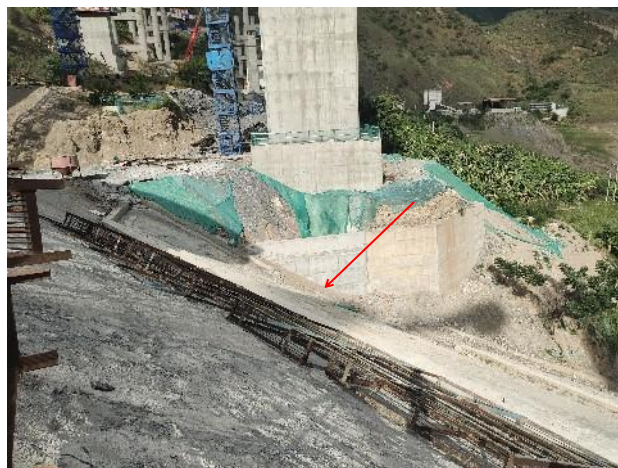
T2 库区反压体桥梁桩基挡墙排水沟堵塞
