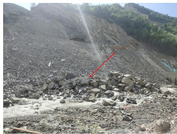
排洪沟出口临沟边坡无拦挡
