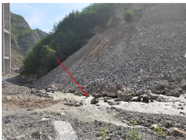
排洪沟出口临沟边坡无拦挡
