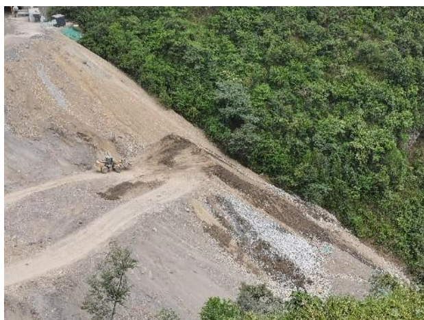
弃渣场堆渣坡度过大
