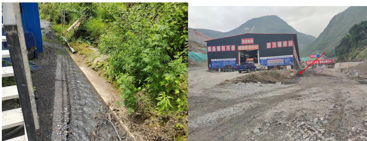
图 5-7 K72+100 鲁沟村弃渣场排水沟堵塞 图 5-8 卡哈洛服务区钢筋加工场排水沟堵塞
