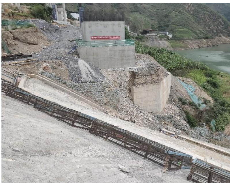
图 5-4 T2 库区反压体边坡临时拦挡措施损坏
