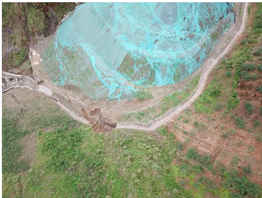
图 5-1 LK3+000 曾家湾子沟弃渣场临时排水沟损坏
