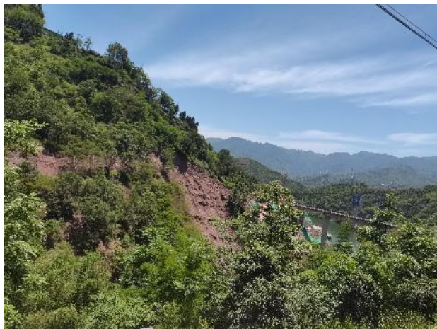
图 5-2 中都河特大桥施工便道边坡挂渣
