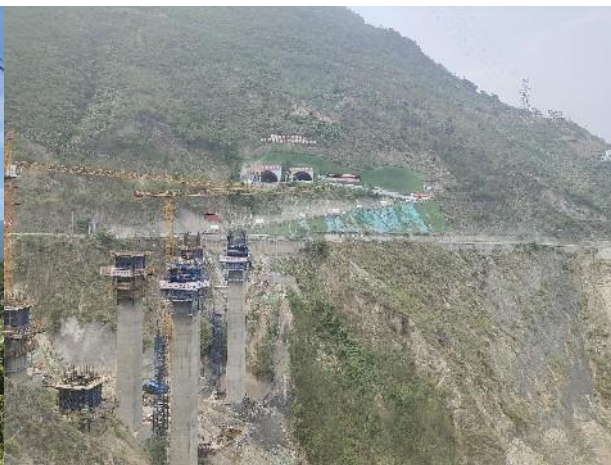
图 5-3 丰家坪大桥桥梁桩基边坡挂渣
