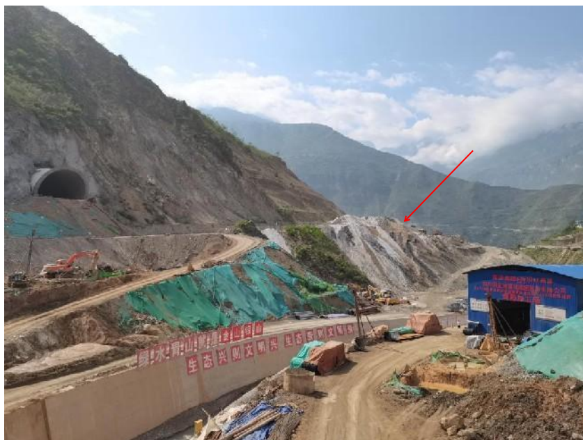
图 5-6 双龙坝 2#隧道反压体已形成高边坡, 削坡分级进度缓慢
