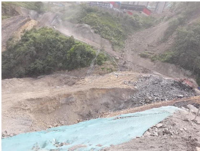
图 5-5 K17+800 唐家湾沟弃渣场削坡分级进度缓慢
