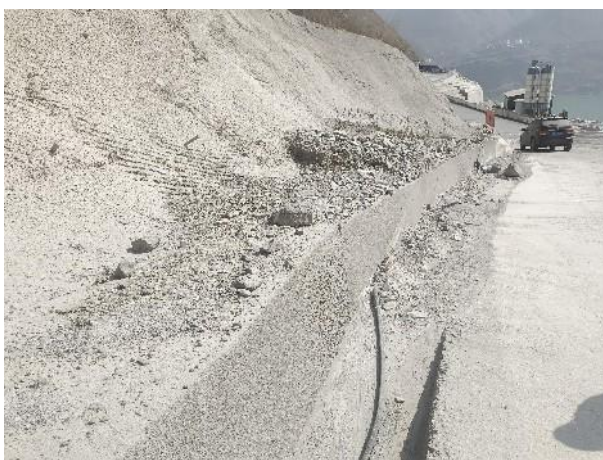
20 标段元宝山隧道出口施工便道排水沟淤积
