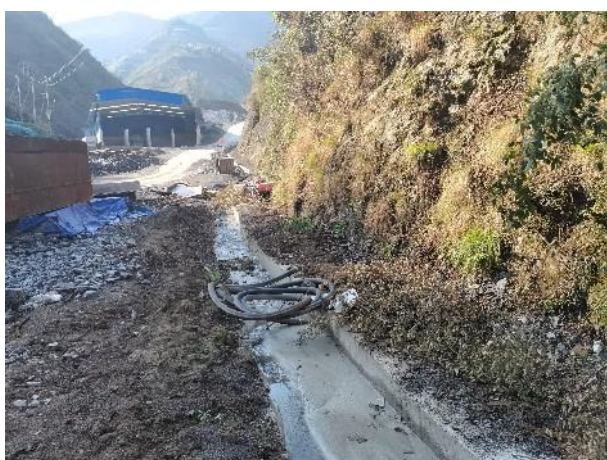
13 标段 K72+100 鲁沟村弃渣场排水沟淤积
