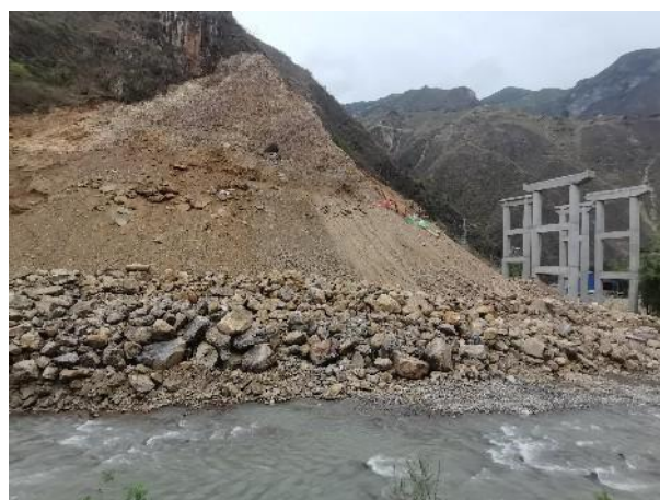
27 标金阳河特大桥施工边坡防护不足
