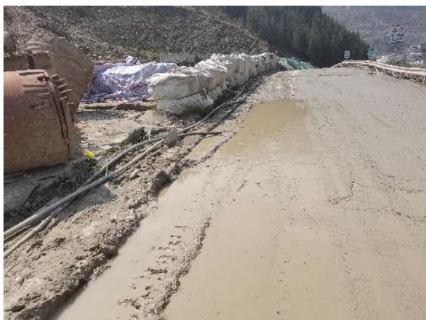
7 标段双河综合体施工便道排水沟淤积
