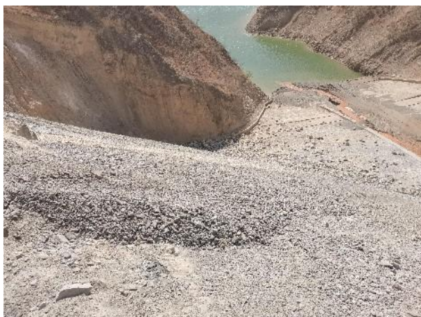
24 标段双龙坝 2#隧道反压体已形成高边坡
