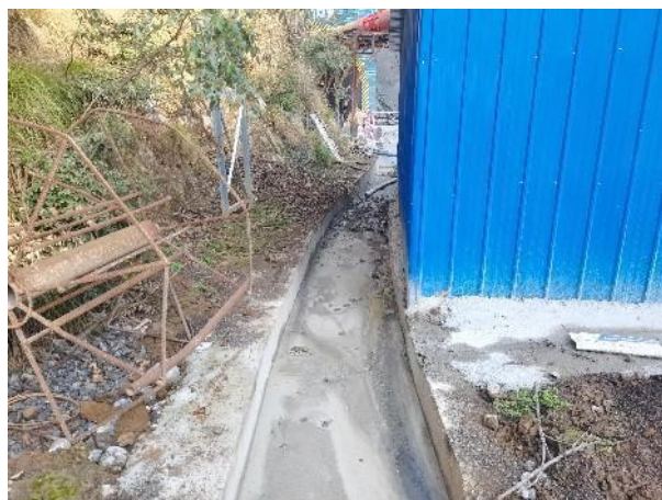
13 标段 K72+100 鲁沟村弃渣场排水沟淤积
