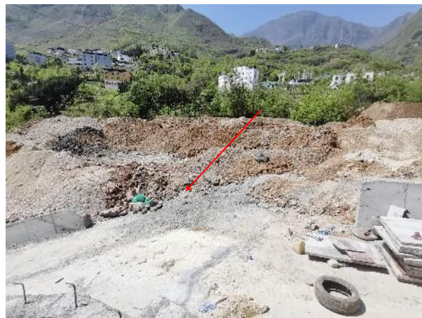
11 标段 K64+000 西边沟弃渣场泄洪沟未完善
