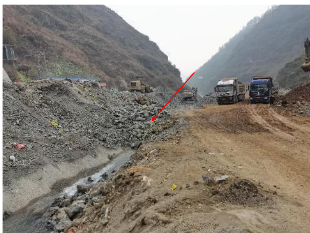
11 标段向阳隧道出口临时转运场泄洪沟堵塞
