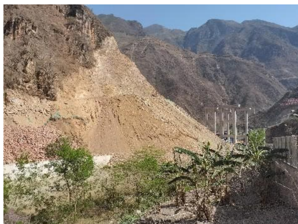
27 标金阳河特大桥施工边坡防护不足
