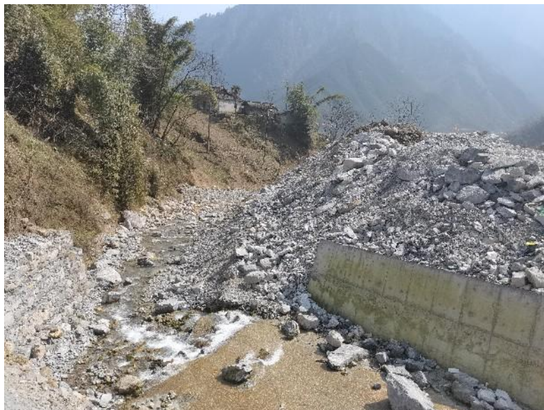
8 标段 K39+000 火烧棚沟支沟便道临沟防护不足
