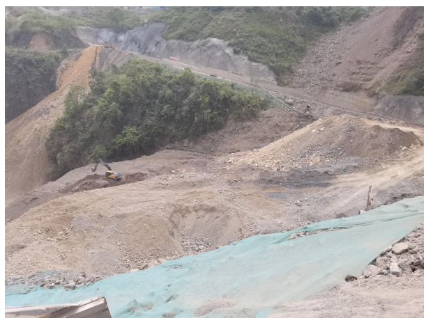
4 标段 K17+800 唐家湾沟弃渣场削坡分级进度缓慢
