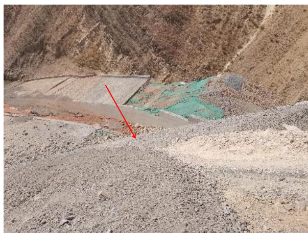
24 标段双龙坝 2#隧道反压体泄洪沟堵塞
