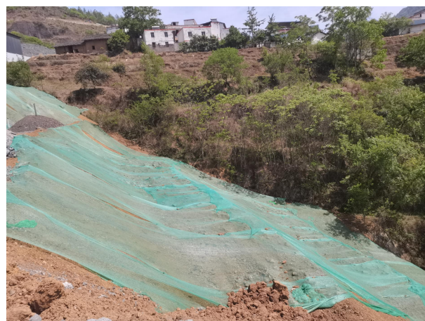
10 标段 K55+060 汶水河支沟弃渣场削坡分级进度缓慢
