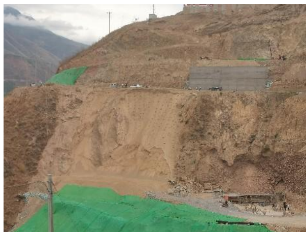
23 标段卢家大桥反压体边坡挂渣
