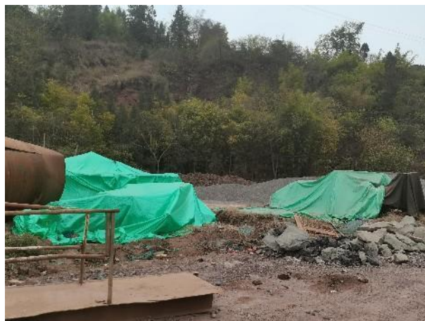
1 标段 K1+168 兵茅坝支沟弃渣场表土堆放区表土堆放不规范
