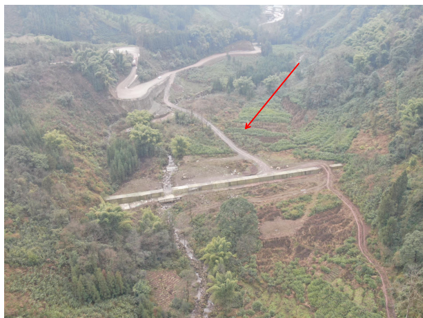
5 标段 K24+000 英雄村沟弃渣场未剥离表土
