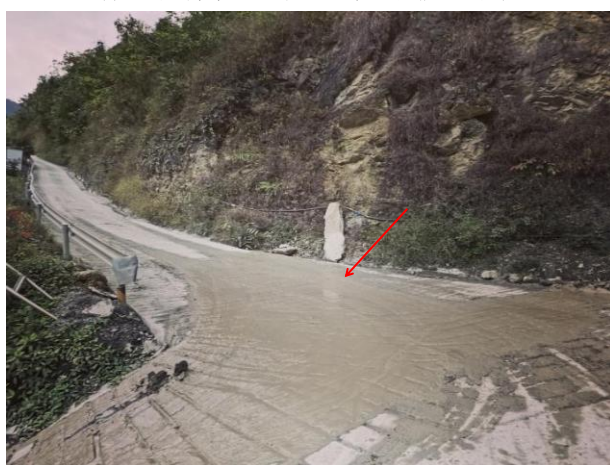
4 标段清平互通施工便道排水沟堵塞
