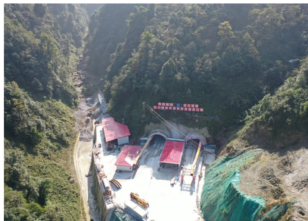
8 标段锦屏隧道进口便道施工产生的弃渣侵占火烧棚支沟河道
