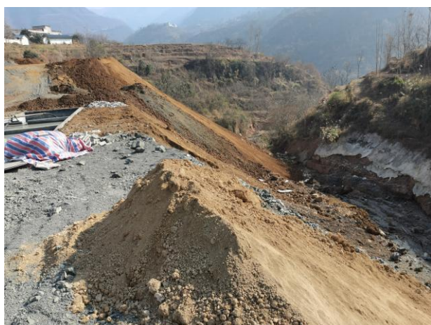
10 标段 K55+060 汶水河支沟弃渣场堆渣坡度过大
