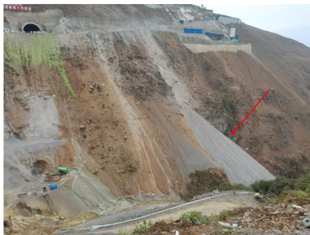
12 标段簸箕 1#隧道出口临沟边坡溜渣
