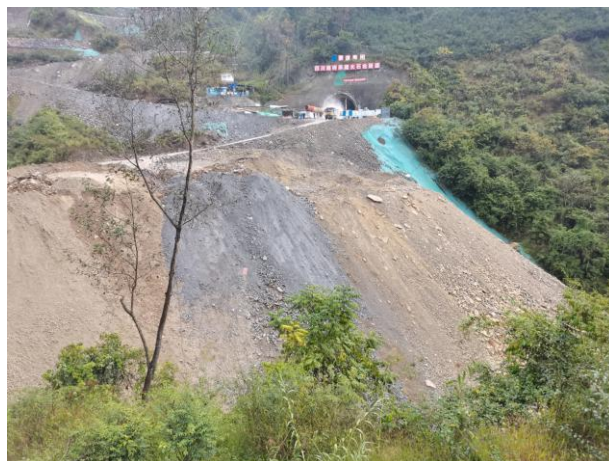
4 标段 K17+800 唐家湾沟弃渣场堆渣坡度过大
