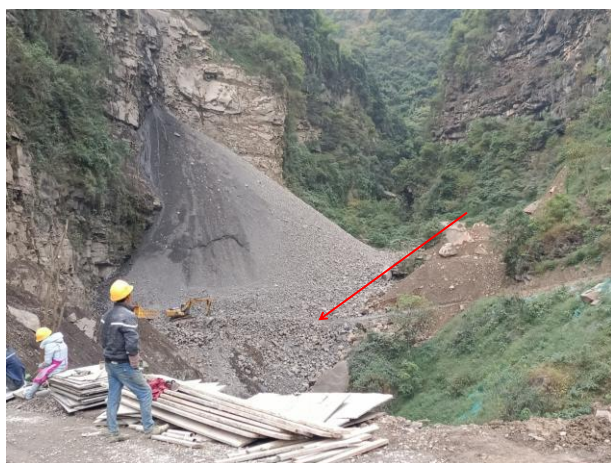
3 标段 K11+900 弃渣场无排水措施
