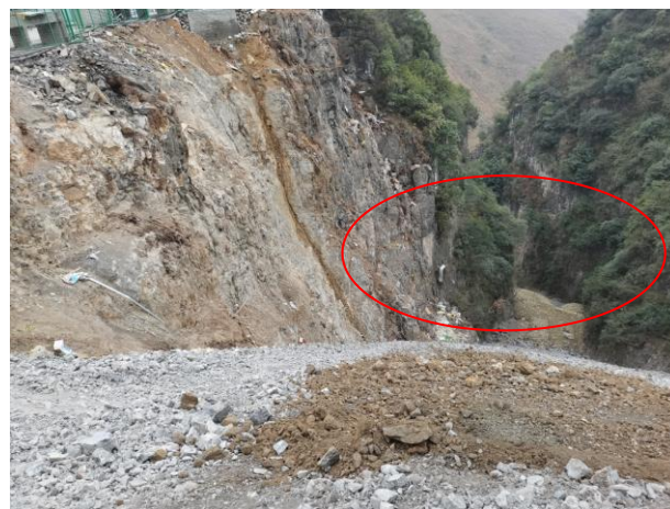
12 标段簸箕二号隧道进口反压体未修建挡挡
