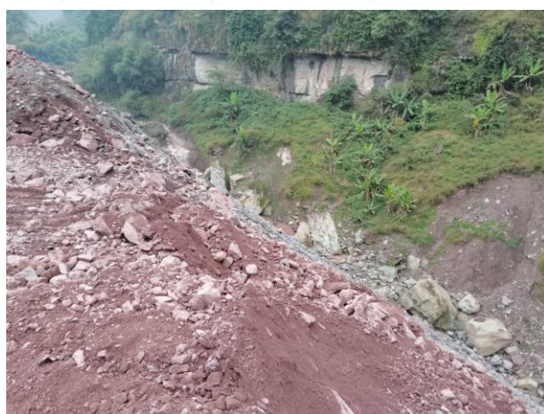
5 标段 K29+000 乌家堡沟弃渣场堆渣坡度过大
