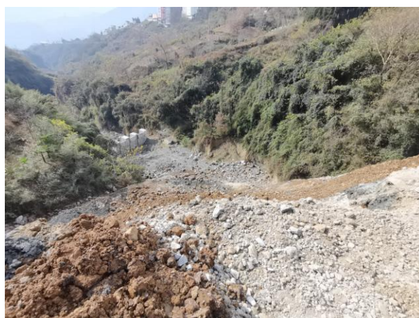
11 标段 K64+000 西边沟弃渣场堆渣坡度过大
