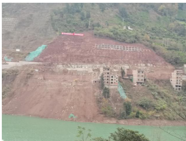
2 标段西宁河特大桥金阳端施工边坡溜渣入江
