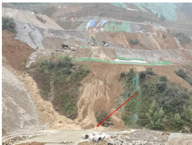
7 标段马湖连接线施工便道临沟一侧边坡未修建临时拦挡
