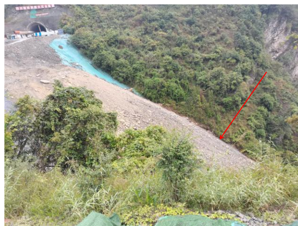
4 标段 K17+800 唐家湾沟弃渣场无排水措施
