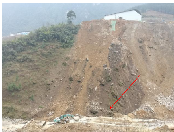
7 标段双河综合体临沟一侧边坡溜渣
