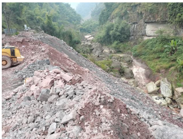
5 标段 K29+000 乌家堡沟弃渣场无排水措施
