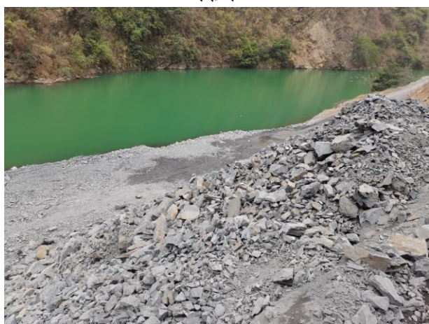
15 标段西苏角 2#隧道出口临时转运场未修建临时拦挡
