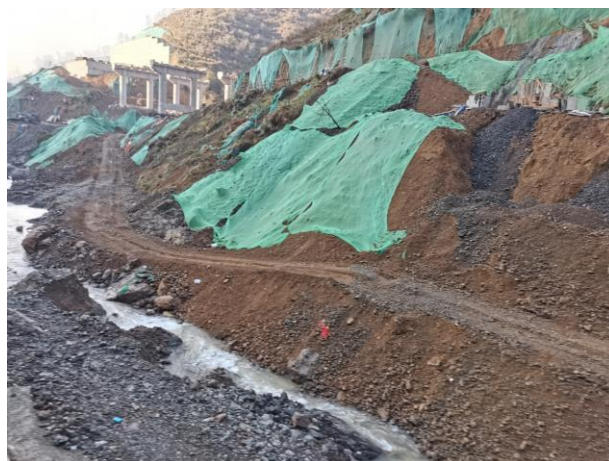
9 标段锦屏隧道出口临沟一侧边坡未修建临时拦挡
