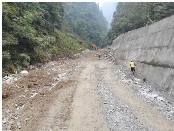
8 标段锦屏隧道进口便道施工产生的弃渣侵占火烧棚支沟河道
