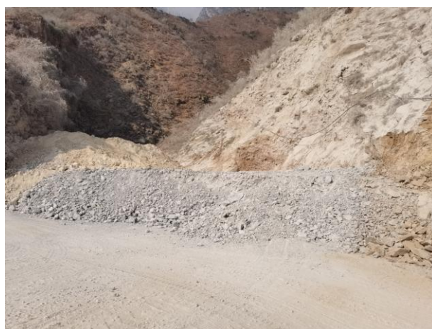
17 标段核桃坪隧道横洞进口临时转运场未修建临时拦挡
