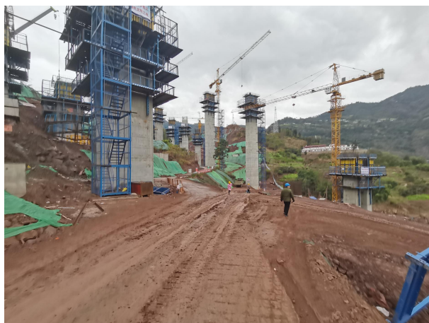
1 标段杨柳坝互通施工便道排水沟堵塞
