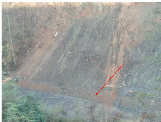
10 标段香樟坝大桥临沟一侧边坡溜渣
