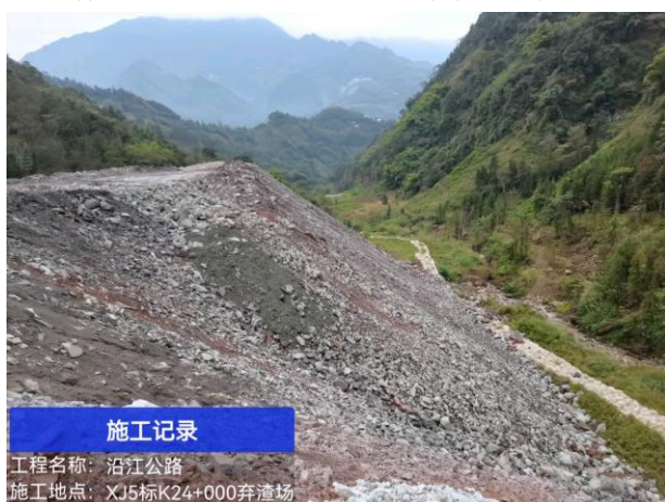
5 标段 K24+000 英雄村沟弃渣场堆渣坡度过大
