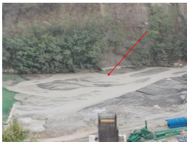
19 标段卡哈洛大桥施工场地临江边坡溜渣
