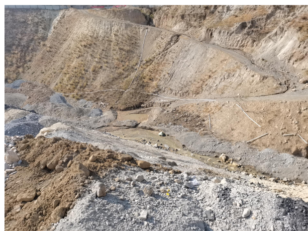
24 标段双龙坝 2#反压体泄洪沟边坡不规范
